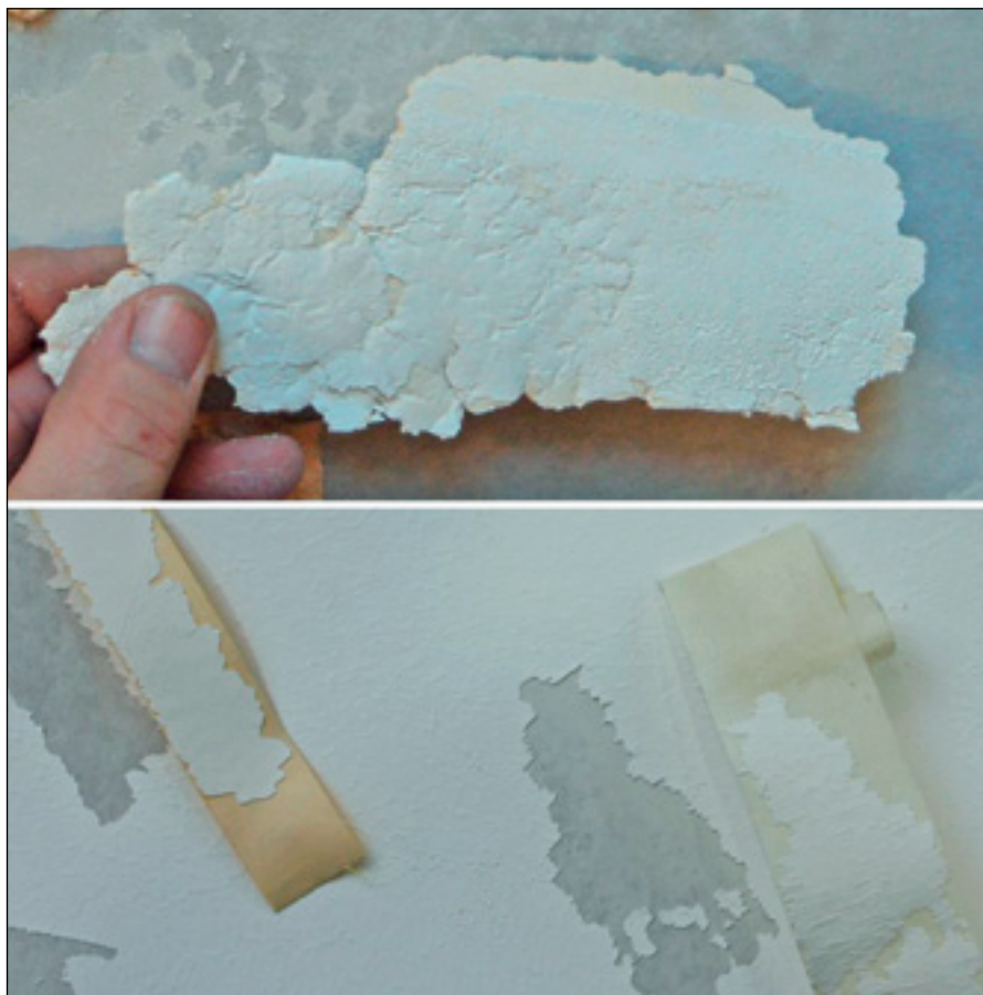
Abb. 1: Abplatzungen bei Gipsspachtelschichten
